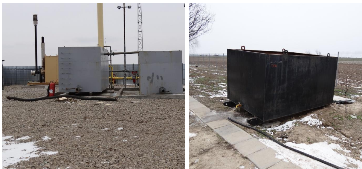
Figura nr. 2-3 Model de habă de apă amplasată pe una din locațiile Amromco Energy
