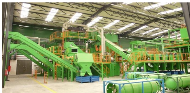
Fig. VII.1.3.1.2. SC Greenweee International SA - Instalații tratare DEEE
