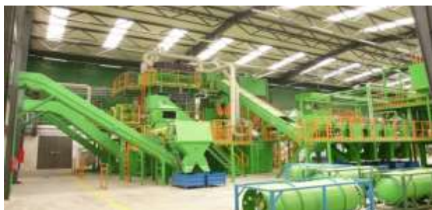
Fig. VII.1.3.1.2. SC Greenweee International SA - Instalații tratare DEEE
